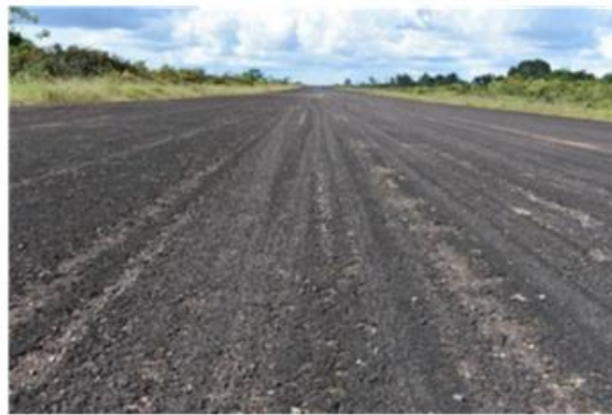
Figura 2 – Desagregação de pavimento em grau avançado, com buracos na pista, típico de pavimentos envelhecidos. (Fonte: FDCA)
