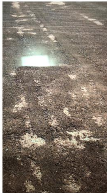
Figura 3 – Desagregação de pavimento em grau avançado, com buracos na pista, típico de pavimentos envelhecidos. (Fonte: Denúncia canal Fale com ANAC)
