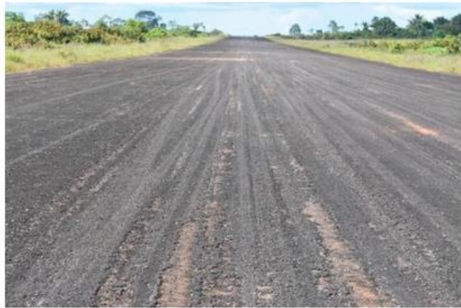
Figura 1 – Desagregação de pavimento em grau avançado, com buracos na pista, típico de pavimentos envelhecidos. (Fonte: FDCA)
