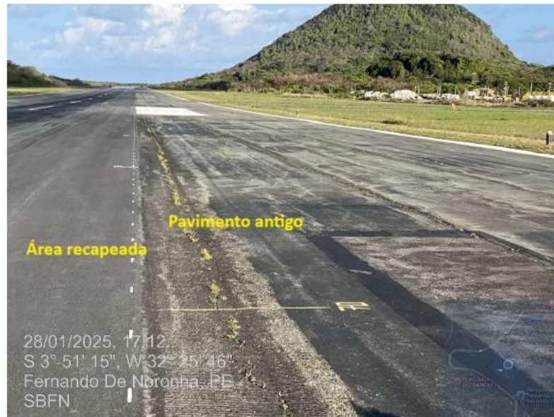
Figura 2 - Divisa entre a área recapeada e a área com pavimento antigo, nas proximidades do ponto de visada da cabeceira 12
