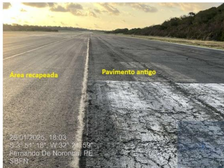
Figura 3 - Divisa entre a área recapeada e a área com pavimento antigo, nas proximidades do ponto de visada da cabeceira 30
